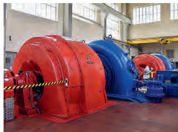
Blau für Wasser, Rot für Strom
