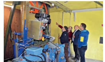
Maschinenraum mit neuem Antrieb
